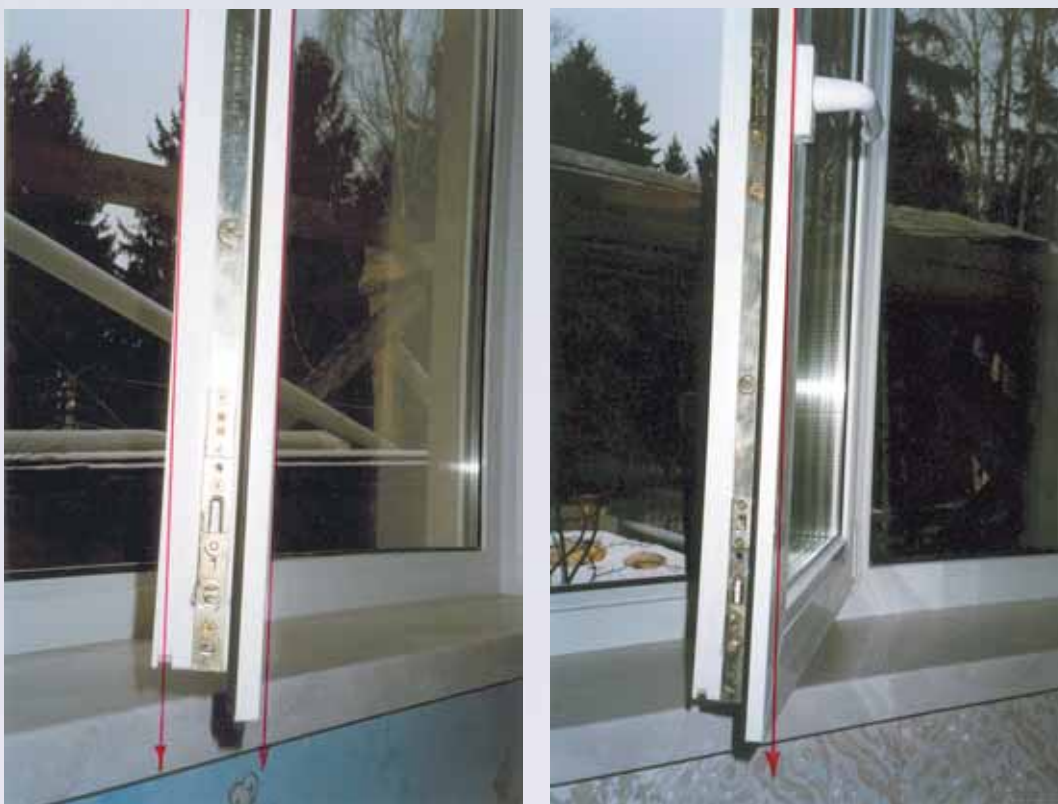
Рис. 3. Деформация оконных створок окна из ПВХ-профиля. Окна эксплуатируются менее одного года. Район строительства – Московская обл.
