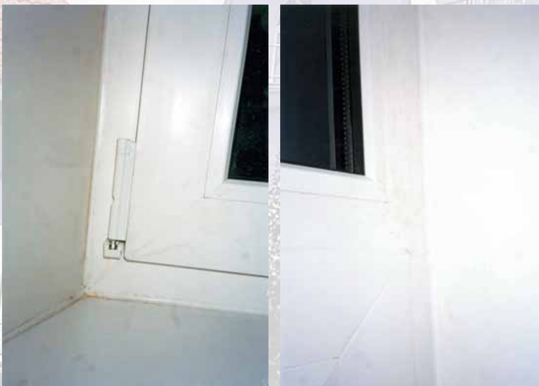
Рис. 1. Внешние признаки коррозии армирующего профиля в окне из ПВХ
