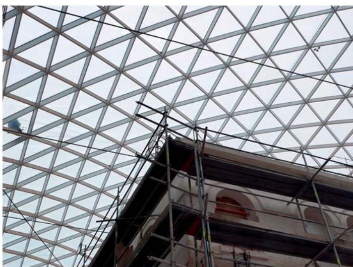
Основной вес в светопрозрачных конструкциях приходится не на алюминиевый каркас, а на стекло или стеклопакеты различных габаритов и структуры
