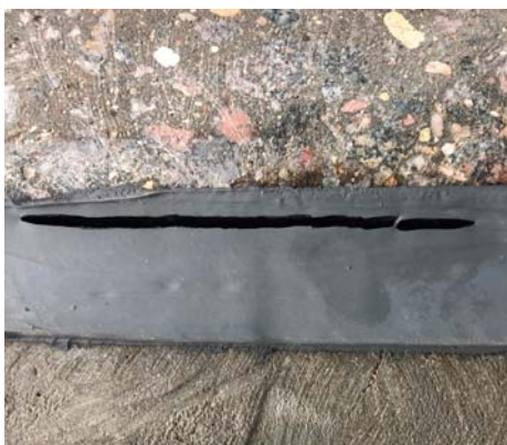
Рис. 1. Фотография «плоского» шва между бетонными плитами. Возник разрыв герметика у одной из стенок шва
