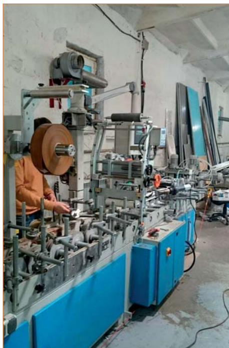
Переоборудование компанией «Экстру-Тех» ламинатора FUX на ПУР-систему
